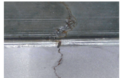
Трещины уже после частичной обработки
